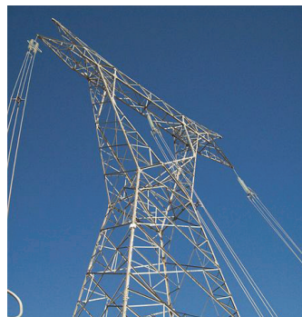
Una torre elèctrica a Argentona.
