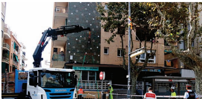
Operacions a Premià de Mar a l'edifici sinistrat
