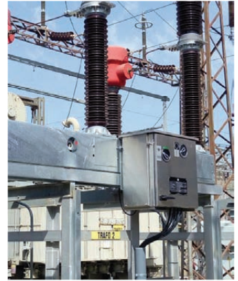
La subestació de Mataró
