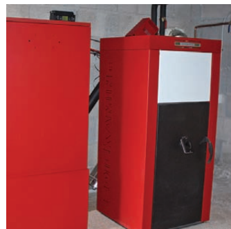
Caldera de Biomassa
