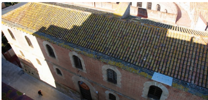
La coberta de la Presó requereix obres de millora
